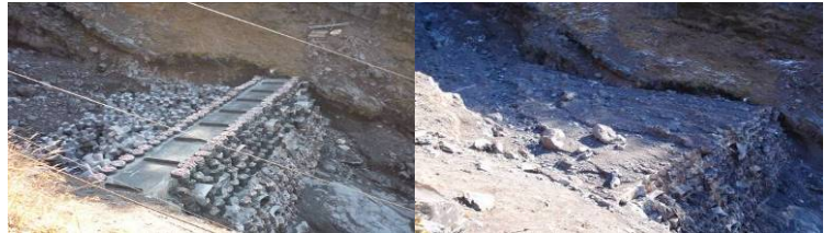
写真1. 平成21年11月土石流発生前(左)と土石流発生後(右)
