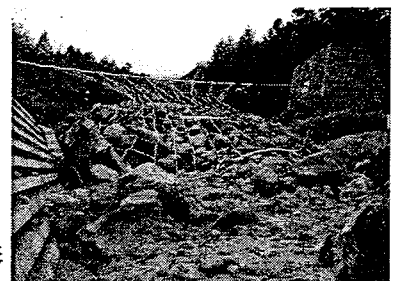
写真-2 第1回目の土石流捕捉状況
