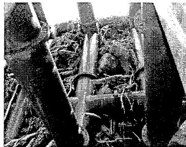
写真-1 土石流捕捉後、満砂した砂防えん堤
