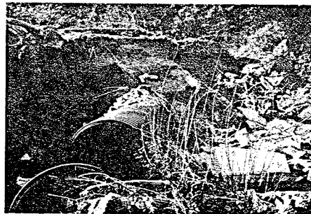
写真 2. 流出溝排水による路体破壊
