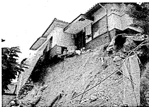
写真-1 石積み擁壁の崩壊（西畑町地区）
