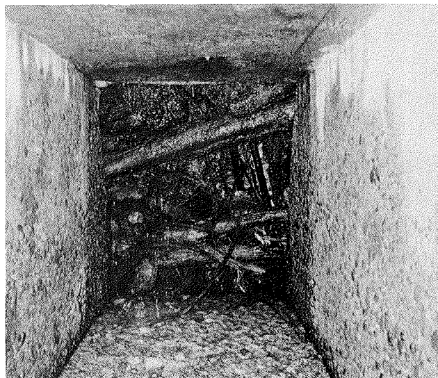
暗渠の閉塞状況写真
