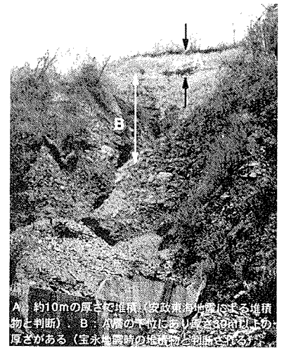
写真-1 白鳥山崩壊地の断面
