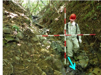
写真③ ガリー侵食(堆積土砂の流出)
