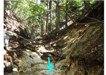
写真④ 溪岸侵食・崩壊(溪床土砂は流出)
