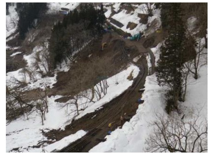
図-5.4 JR 飯山線の被災状況 (榎環境地質 稲垣秀輝氏 3 月 31 日撮影)
