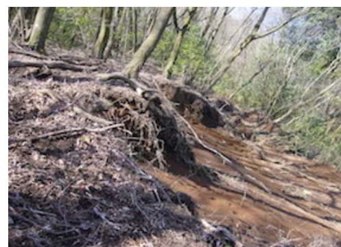
写真 2-1 斜面変状状況（のり肩付近）
