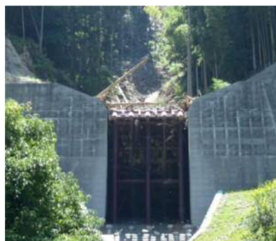
写真-4 土石流・流木捕捉直後
