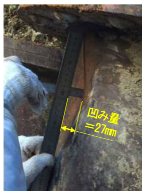
写真-8 凹み測定状況
