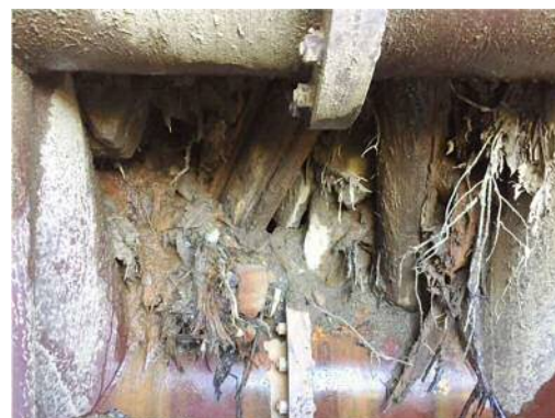
写真-9 捕捉面下部の礫・流木捕捉状況
