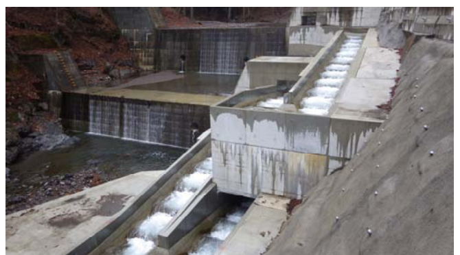
写真 10 立体交差を有する折り返し台形断面魚道
