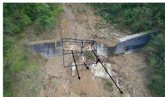
図 2 被災した砂防堰堤 （綾部市消防部局提供、青の破線は非越流部の破壊前の推定位置を示す、番号は破壊により分離した非越流部のブロックに付した番号である）
