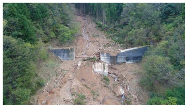
写真1 堰堤被災状況(綾部市消防本部提供)
