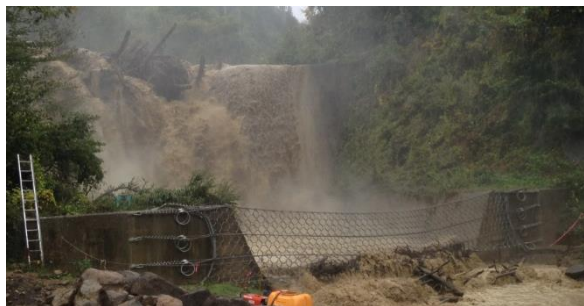
写真-3 強靱ワイヤーネット工により捕捉 された流木（平成 29 年 10 月 23 日撮影）
