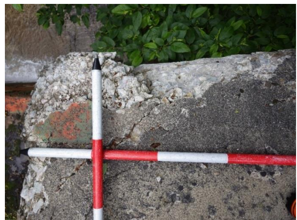
写真-3 硫黄沢上流砂防堰堤の凍害による欠損
