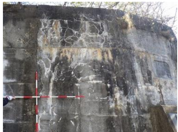
写真-2 倉見川第二砂防堰堤のASRが疑われる網状ひび割れ
