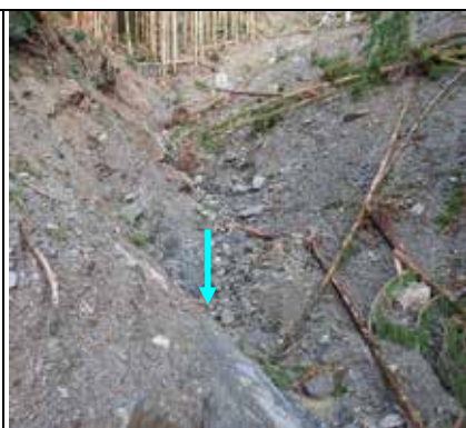
写真 3 崩壊下方の急崖
