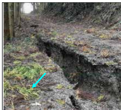
写真 2 崩壊背後の亀裂
