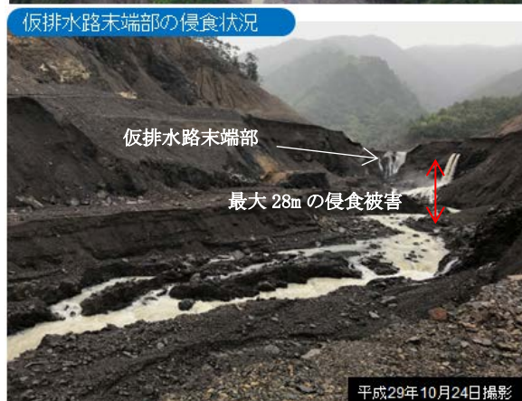
図3 台風 21 号による被害状況
