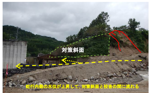
図 5 対策斜面(c)と周辺の表層崩壊(b)の状況
