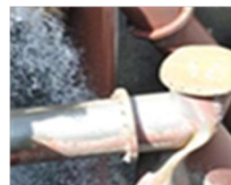
写真-1 接合部の残留へこみ変形 (左の梁が右の柱をへこませている)
