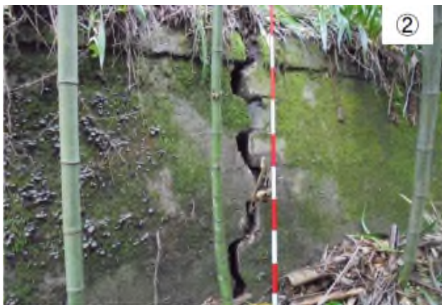
図 2 町道下の擁壁のクラック(開口亀裂約 12cm) 1)
