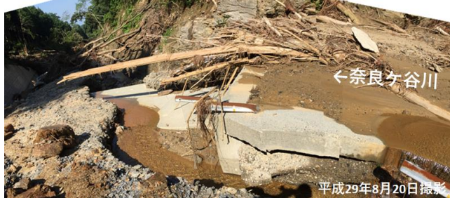
写真-3 カルバート閉塞②と舗装上への氾濫状況
