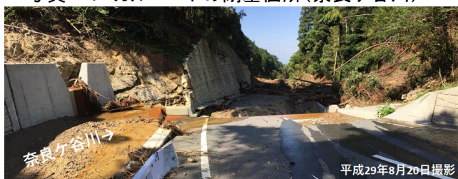
写真-2 カルバート閉塞①と舗装上への氾濫状況
