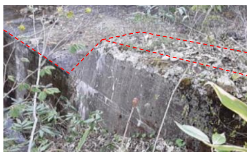
写真－1 凍害による本堤工の断面欠損の状況
