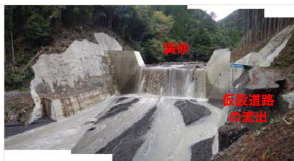
図 6 台風 21 号直後の栗平 1 号砂防堰堤付近の状況
