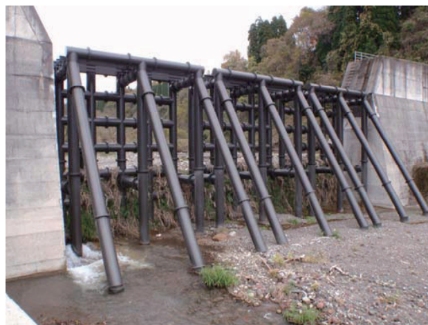
写真1 灌木による部材の目詰まり（平常時）
