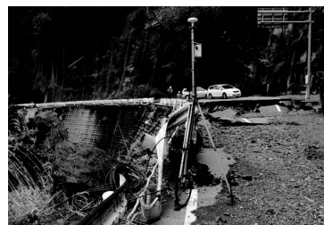
写真2 路面陥没とGPS観測状況
