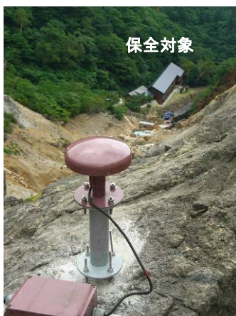
図-2 GPS センサー設置状況
