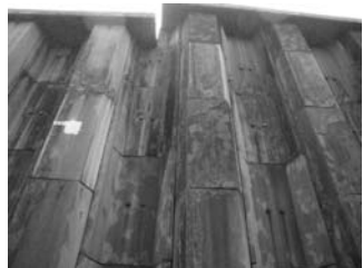
写真-2 鋼製壁面腐食状況 (とんび沢1号堰堤)
