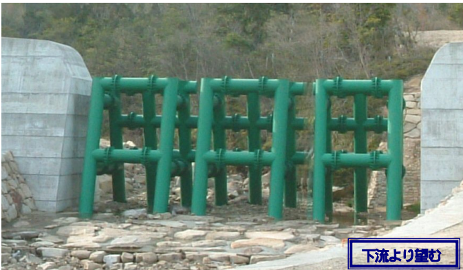
写真-1 土石流捕捉前のスリットダム B 型
