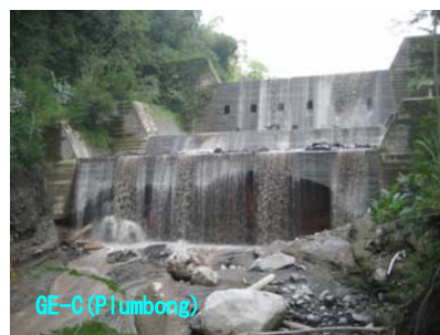
写真-2 河床変動による損壊事例
