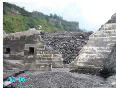
写真-3 摩耗による損壊事例
