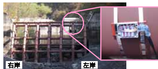
写真1 白谷4号えん堤と土石流検知システム
