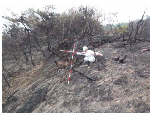
写真－3 火災跡地の侵食状況
