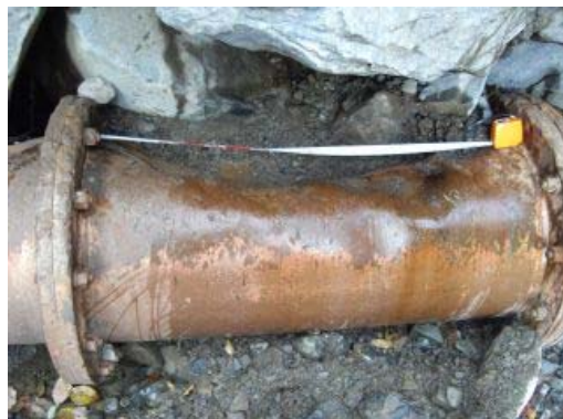
写真4 礫落下による部材の損傷例(大津谷)
