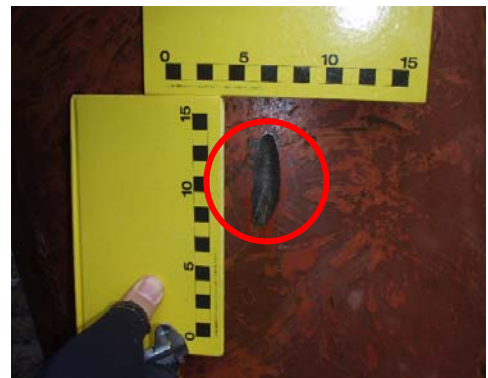
写真 1 最上流部材の損傷の例（舟石川）
