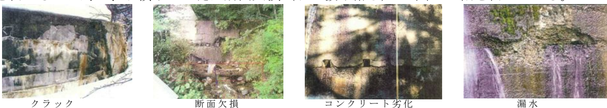
写真－1 損傷性状の例
