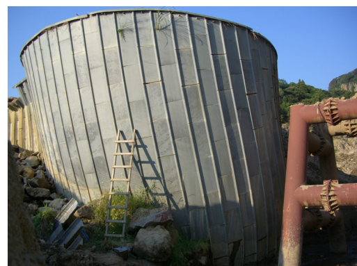
写真-1 鋼製セルえん堤の変形状況
