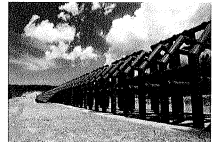
写真・3 土石流捕捉工の設置例（十勝岳）
