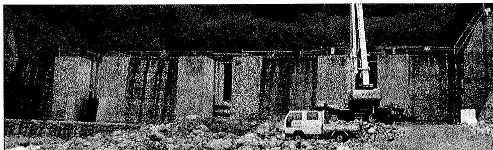
写真 1 鋼製砂防シャッターの全景
