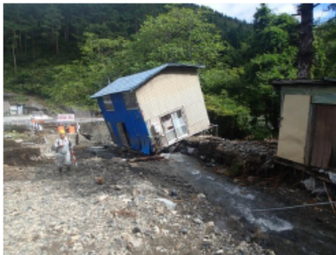
写真1 侵食により傾斜した倉庫(谷出口付近)
