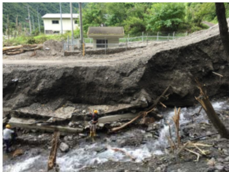
写真12 流出土砂で埋塞した川 (堆積土は応急工事で一部除去)
