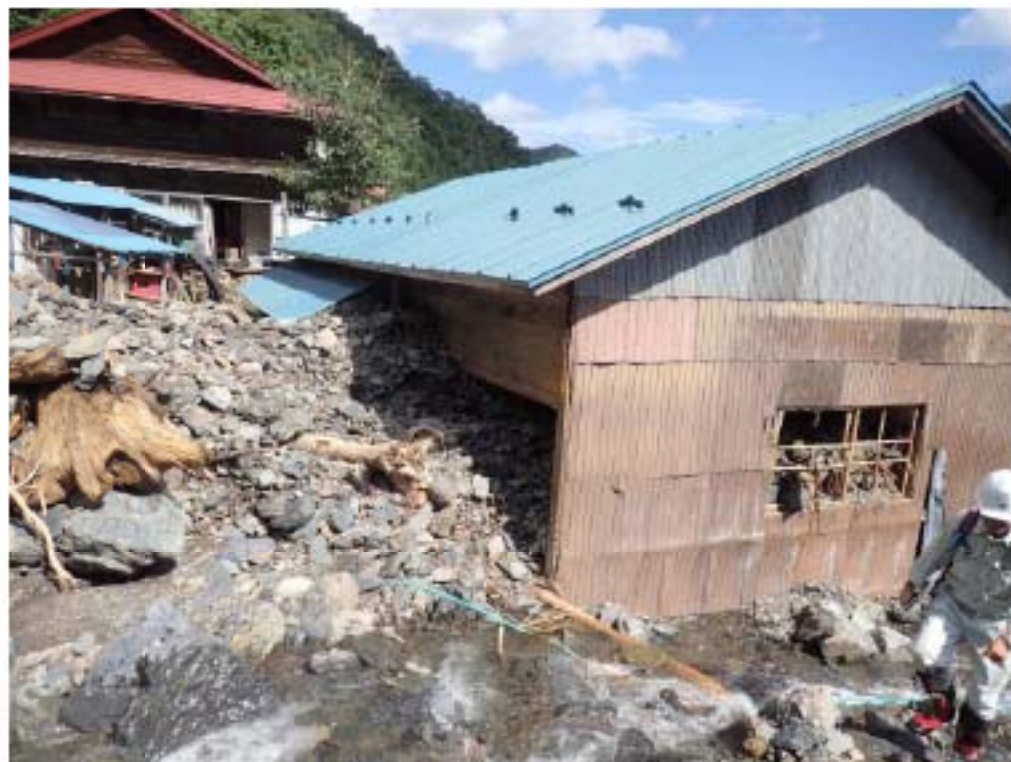
写真9 土石流が流れ込んだ作業小屋
