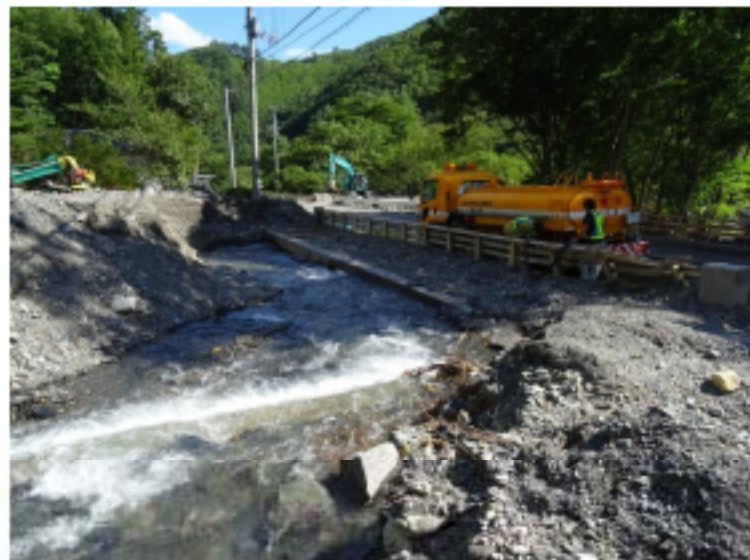
写真14 土石流により閉塞した 橋梁
