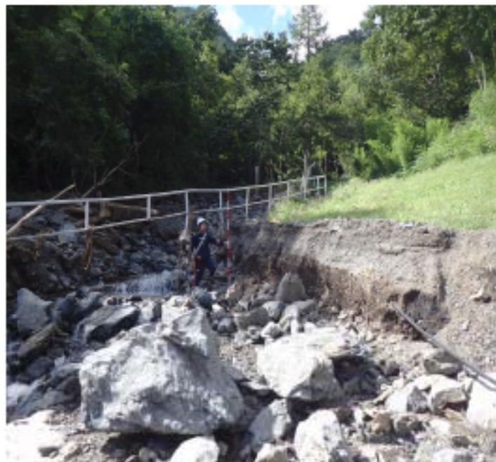
写真8 取水施設下流の状況 著しく侵食された溪岸・斜面(左岸側)
